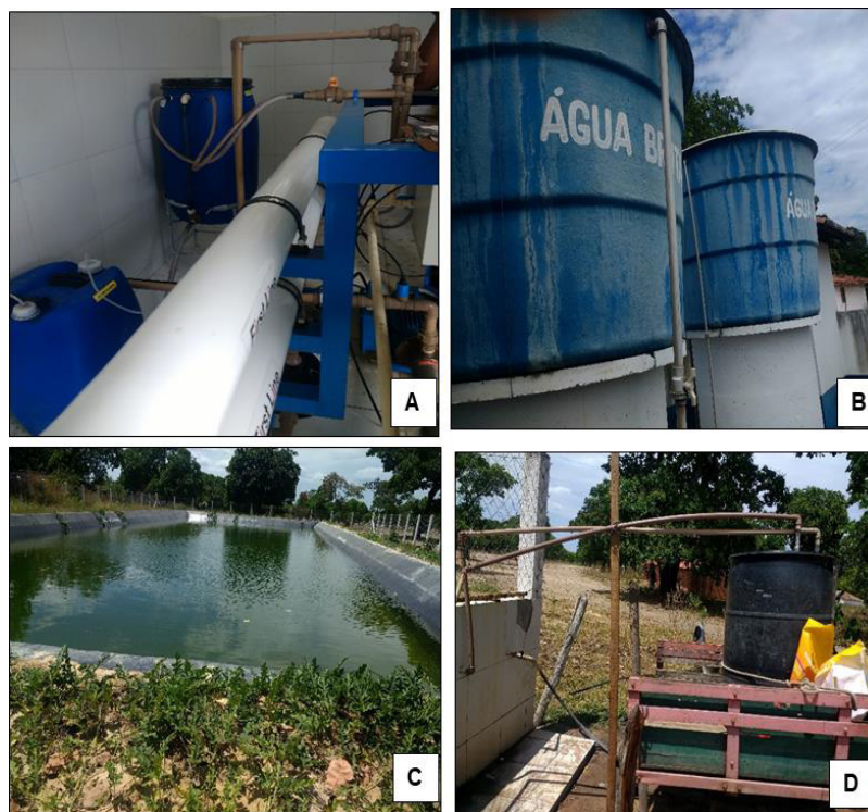
FIGURA 3 - Imagens de equipamentos referentes às etapas do processo de dessalinização na Comunidade Grossos. A) Dessalinizador por osmose reversa; B) Reservatórios de armazenamento de dessalinizada e de água bruta; C) Tanque de concentrado; D) Ponto de junção da água bruta com o rejeito.
