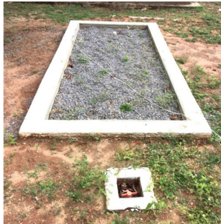
Figura 2. Vista superior sistema alagado construído.
