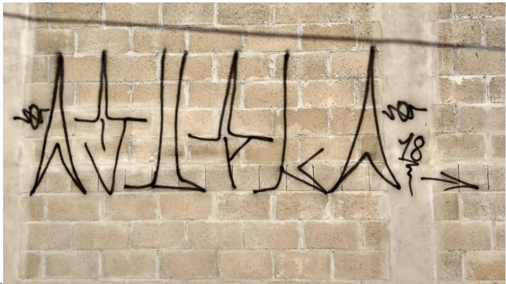
Figura 1: Tag sobre fachada de prédio. Centro, Rio Grande/RS
