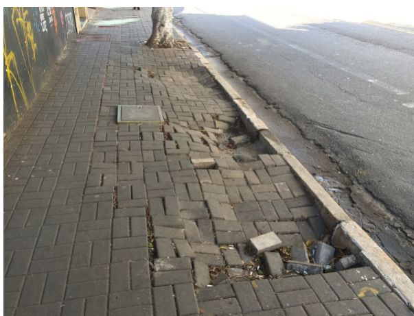
Figura 2 – Inter travado de Concreto solto ou defeituoso na calçada Rua Augusta – 2016
