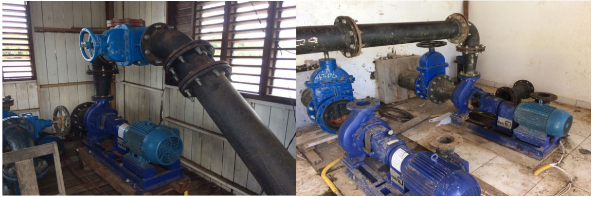
Figura 8. Bombas de captação e distribuição de água da ETA da COSANPA.
