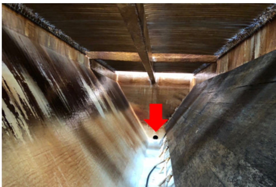
Figura 1: Válvula de descarga do decantador
