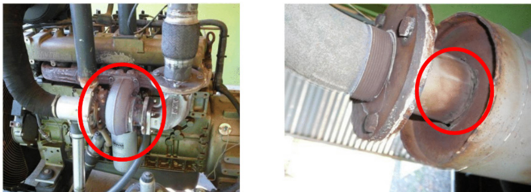
Figura 01(A) Turbina do Motogerador (B) Perfuração no escapamento do Motogerador
