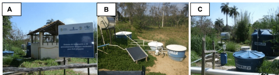
Figura 1. A, B e C: Sistema de tratamento da ARB, utilizado no experimento.
