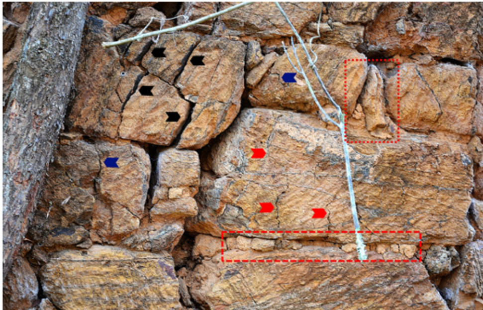
Figura 2 – Trecho de parede das ruínas da Capela de Nossa Senhora do Rosário
