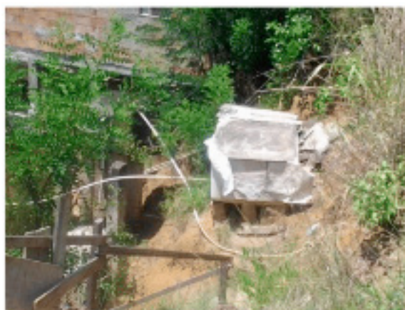
Figura 4 – Rede de encanamentos de água e esgoto aparente e subaérea.
