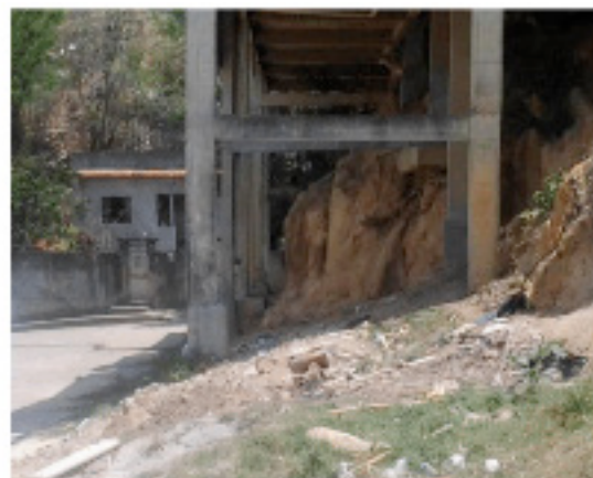
Figura 3 – Bases estruturais de construções aparentes e degradadas, associadas à erosão do solo.
