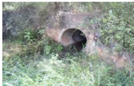
Figura 03. Lançamento de Efluente Doméstico.
