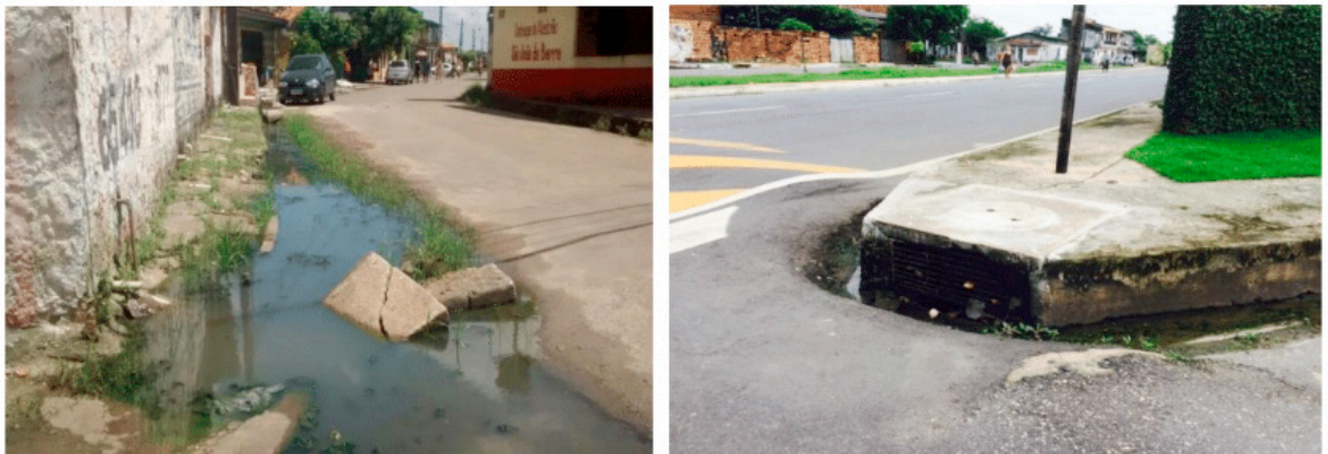
Figura 1 – Bueiro submerso devido a obstrução ocorrida. Figura 2 – Boca de lobo com boa infraestrutura, porém mal posicionado.
