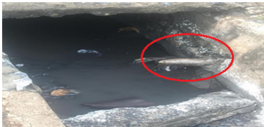
Figura 5 – Ligação Clandestina de Rede de Esgoto na Rede de Drenagem Pluvial.
