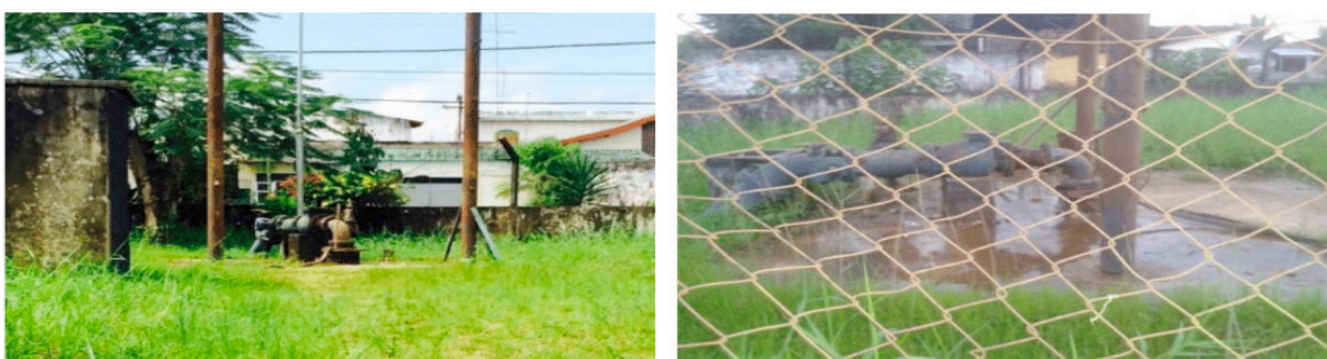
Figura 3 – sistema de abastecimento de água potável em estado de oxidação. Figura 4 – vazamento da tubulação percebida pelo acumulo de água envolta da tubulação.
