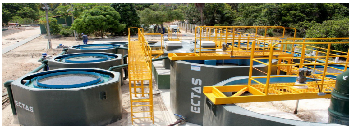
Figura 4 - Estação de tratamento de efluente Iberostar
