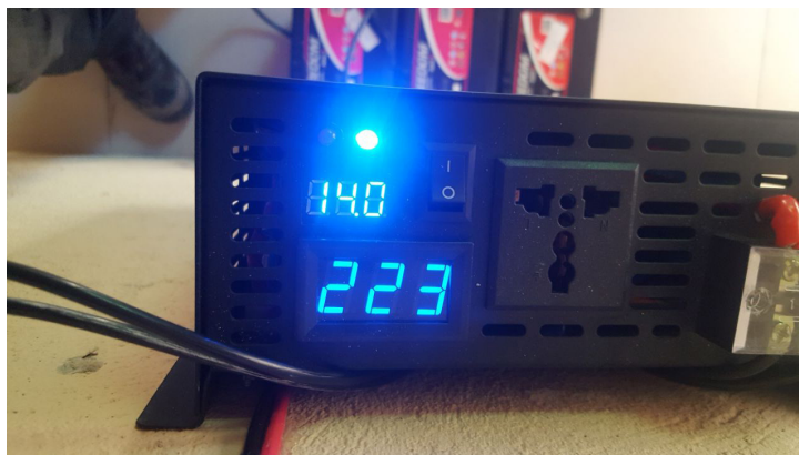
Figura 07 - Display do inversor
