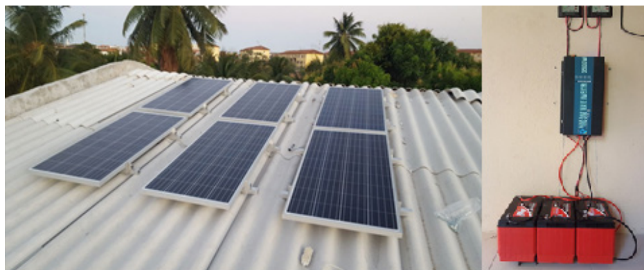
Figura 05 - Painéis fixados no telhado
