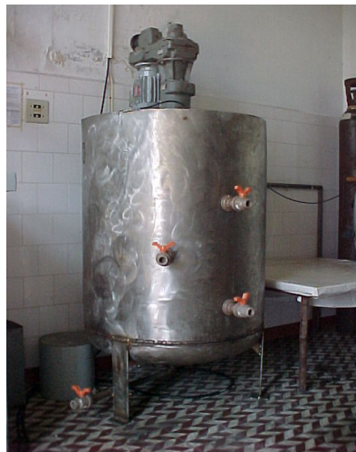
Figura 6. Vista parcial do reator biológico, com capacidade de 500L
