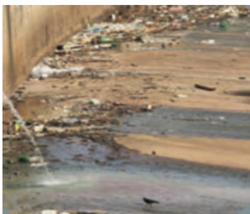
Figura 02: Esgoto clandestino no Ribeirão Arrudas
