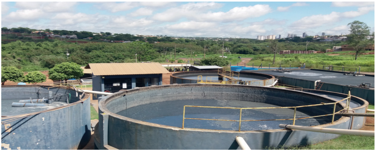
Figura 1: Central de tratamento de efluentes.
