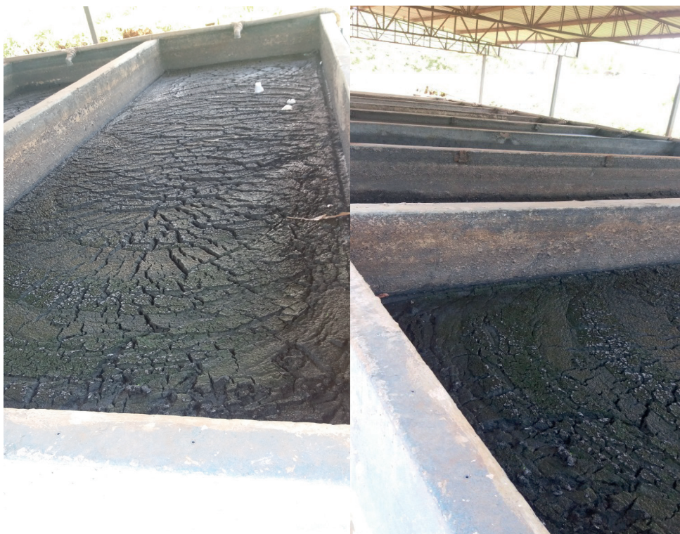
Figura 4: Tanques de secagem de lodo.
