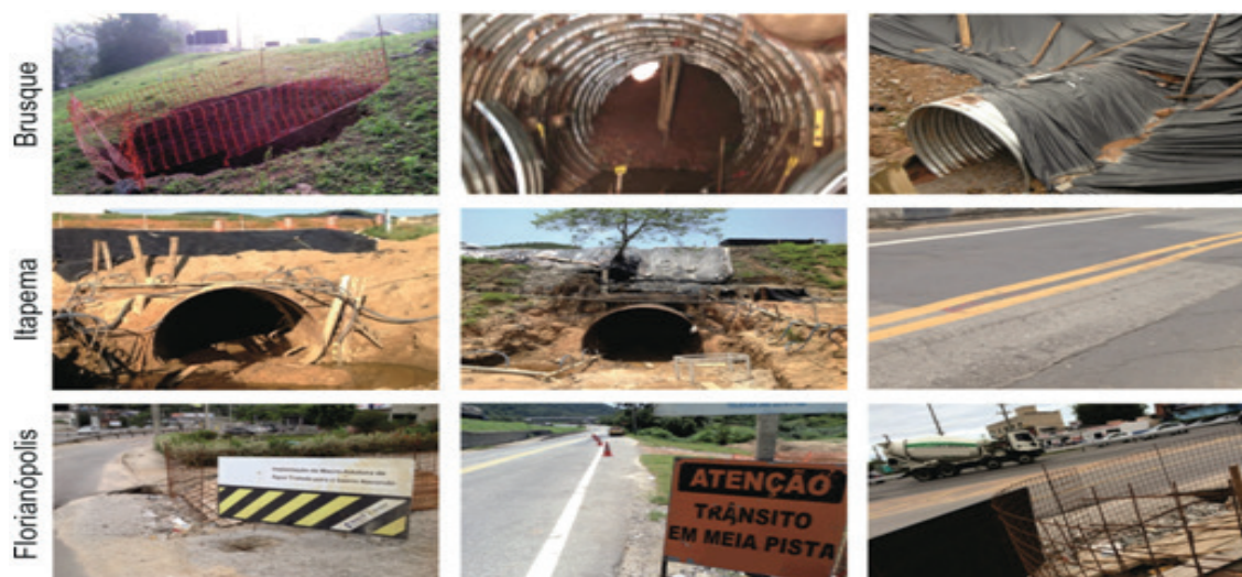
Figura 1 – Problemas com escavação manual em Santa Catarina entre 2012 e 2014.
