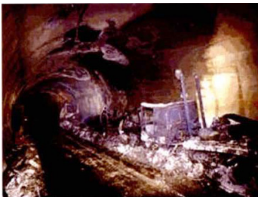
Figura 3. Túnel de Mont Blanc após a tragédia.
