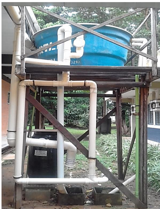
Figura 1- Sistema de captação da água da chuva instalado no NUMA.
