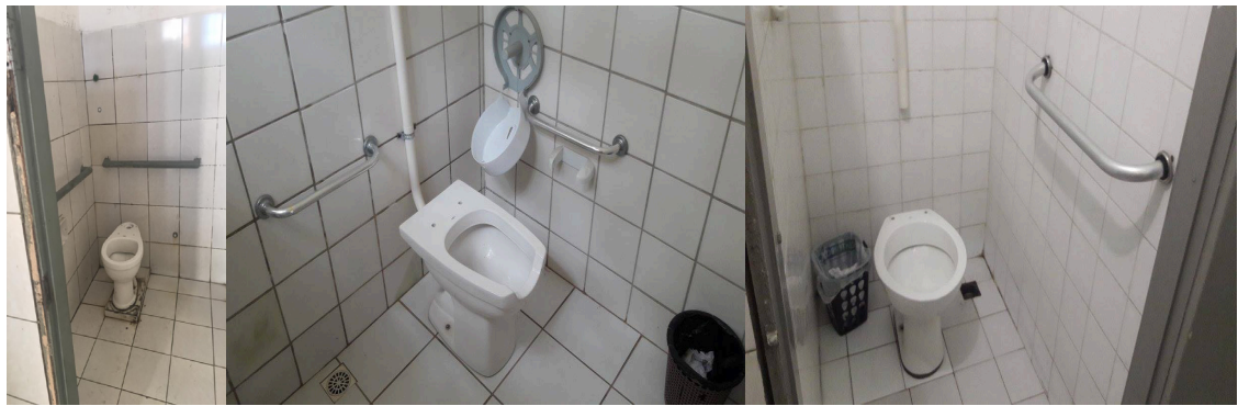
Figura 24 – Banheiro acessível em desacordo com a NBR 9050/2015.
