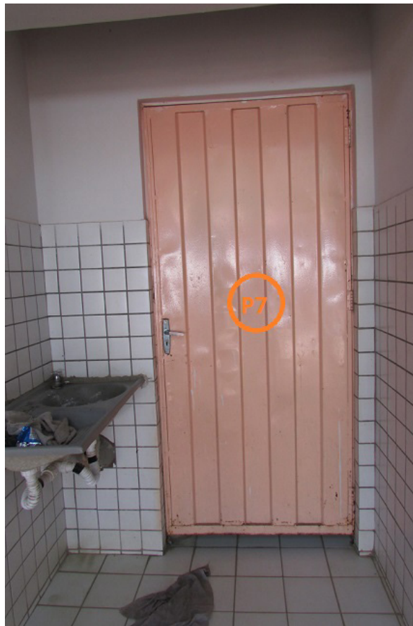
Figura 11– Porta P7 do banheiro para deficientes.
