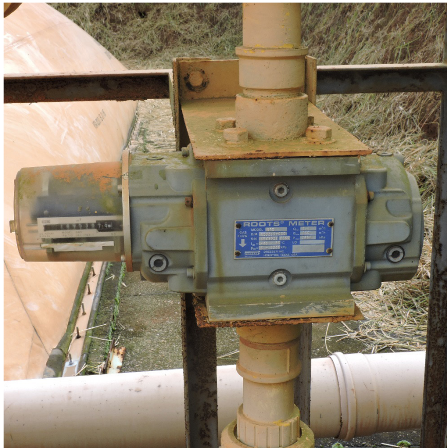
Figura 10. Medidor de vazão (Fonte própria).
