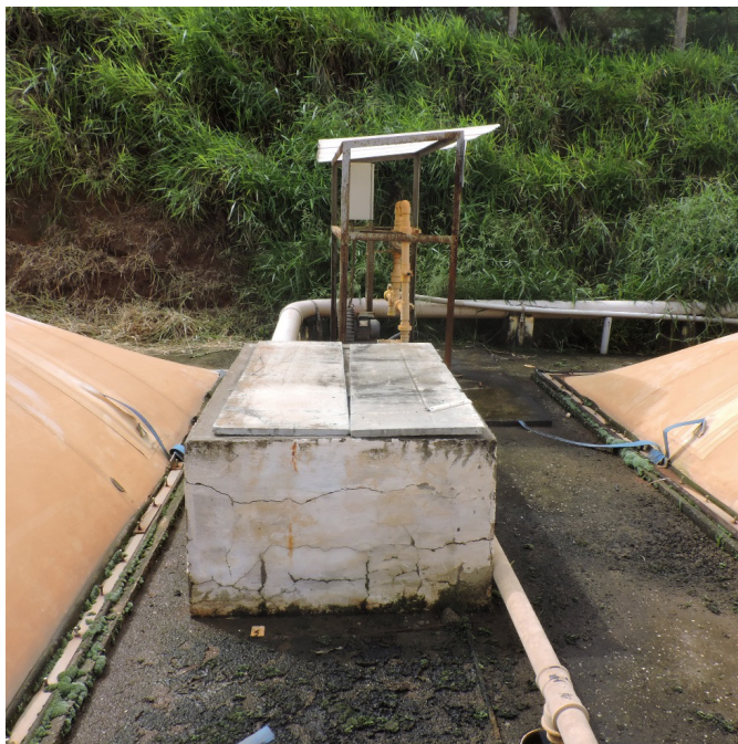
Figura 7. Caixa de distribuição (Fonte própria).
