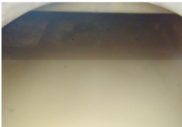
Figura 9: Tanque de armazenamento sem resíduos
