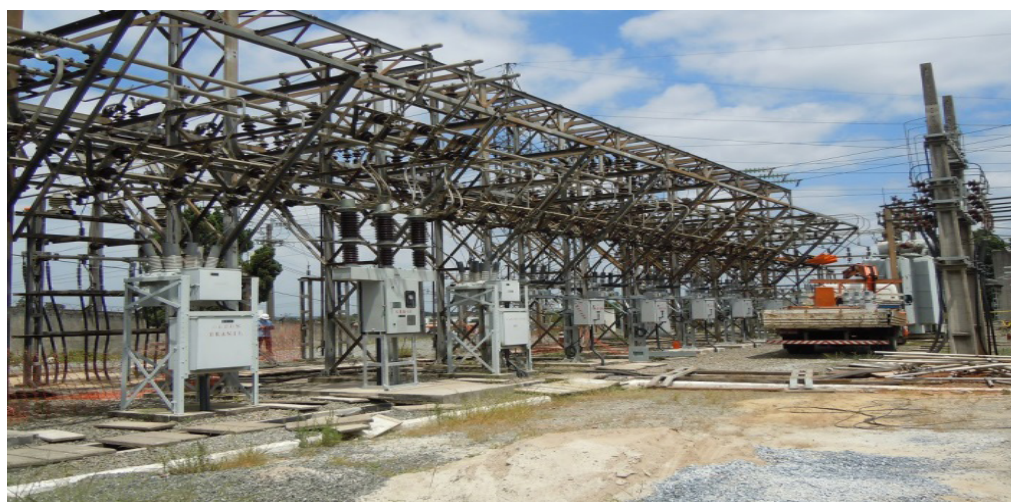
Figura 1. Ambiente de uma subestação
