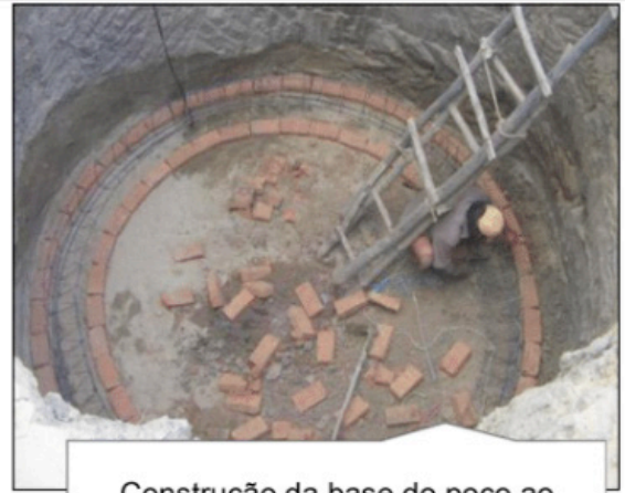
Construção da base do poço ao realizar a execução de anel com estrutura em concreto armado
