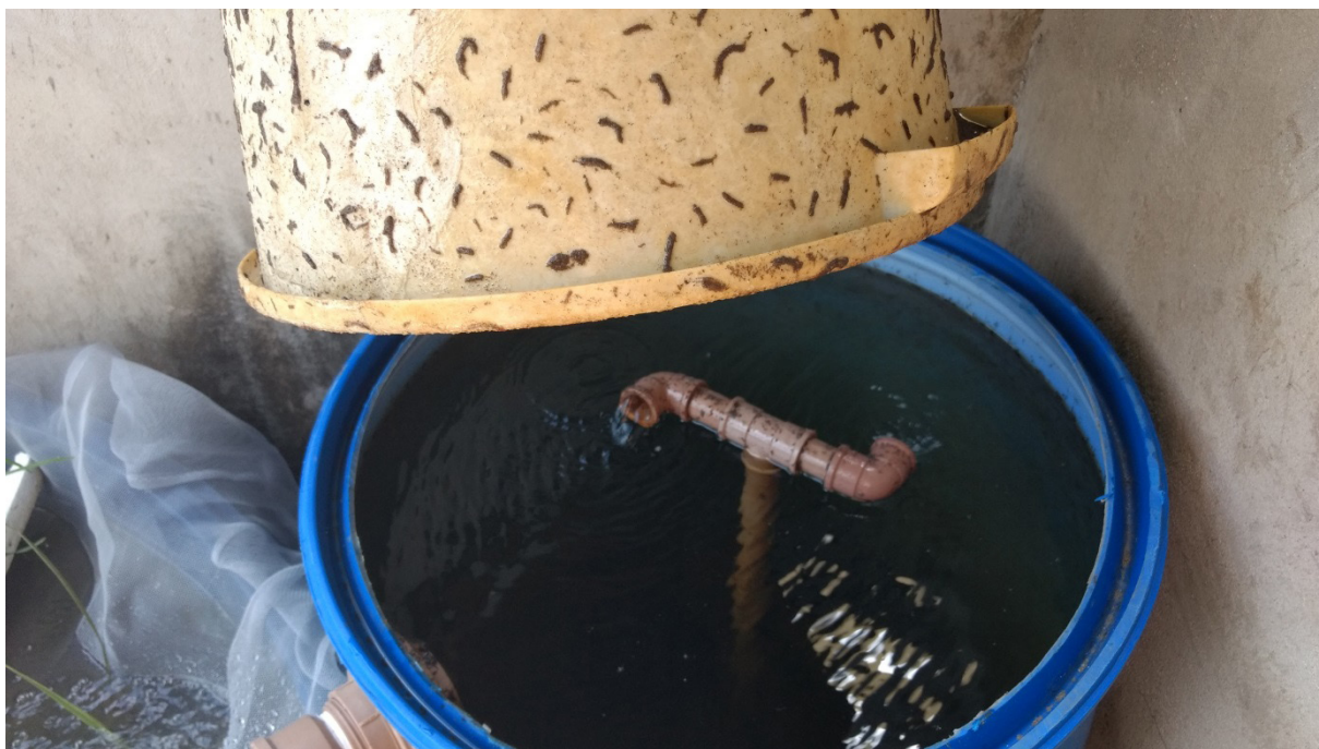
Figura 3 - Filtro de sólidos decantáveis.
