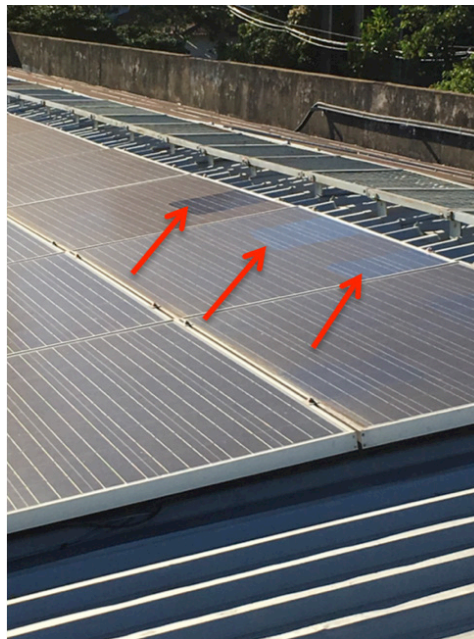
Figura 3: Sujidade depositada sobre os módulos.
