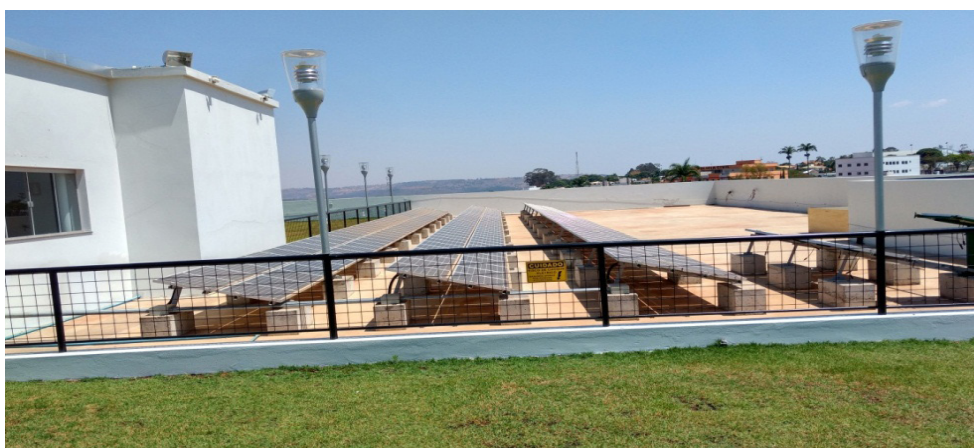
Figura 3 - Micro usina fotovoltaica UNIPAM
