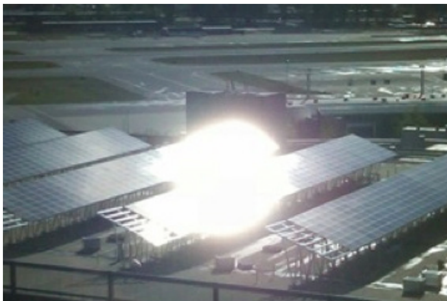
Figura 7 - Imagem do sistema FV do Manchester-Boston Regional Airport visto da torre de controle (KANDT; ROMERO, 2014).
