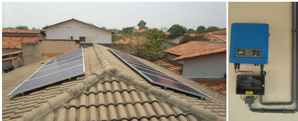
a) Módulos fotovoltaicos
