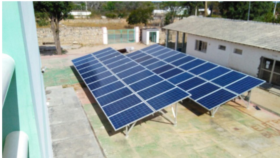
Figura 4. Sistema Fotovoltaico On-grid instalado no IFBA-Campus Paulo Afonso.
