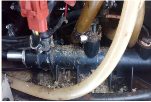
Figura 1: Foto da região interna da primeira PA com partes metálicas oxidadas logo a baixo dos tanques dos químicos.
