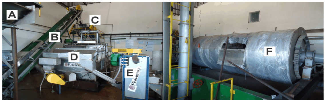
Figura 7 – Vista geral da Usina de Processamento Pós-Colheita de Guaraná instalada na Jayoro - A: Moega de Recepção; B: Transportador; C: Despolpador; D: Lavador/Separador; E: Deslizador e, F: Secador rotativo. Todos os equipamentos confeccionados em aço inoxidável.
