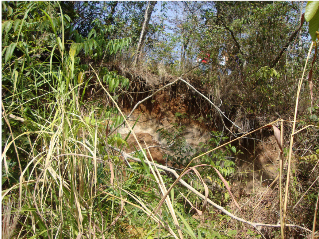
Foto 02- Voçoroca no lote 14, Assentamento Santa Rita, Jataí (GO).
