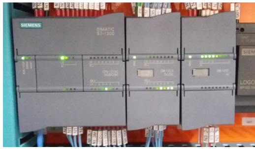
Figura 6. CLP Siemens S7-1200 e módulos adicionais conectados via barramentos laterais.
