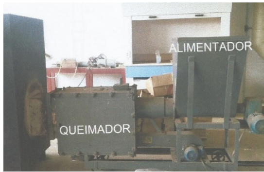
Figura 4: Sistema de queima de biomassa
