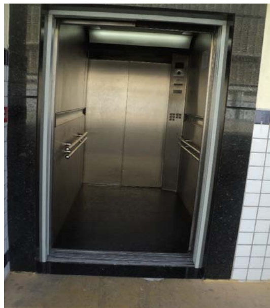
Figura 6. Elevador assistivo do prédio A do IFPI. Mesquita, 2014.
