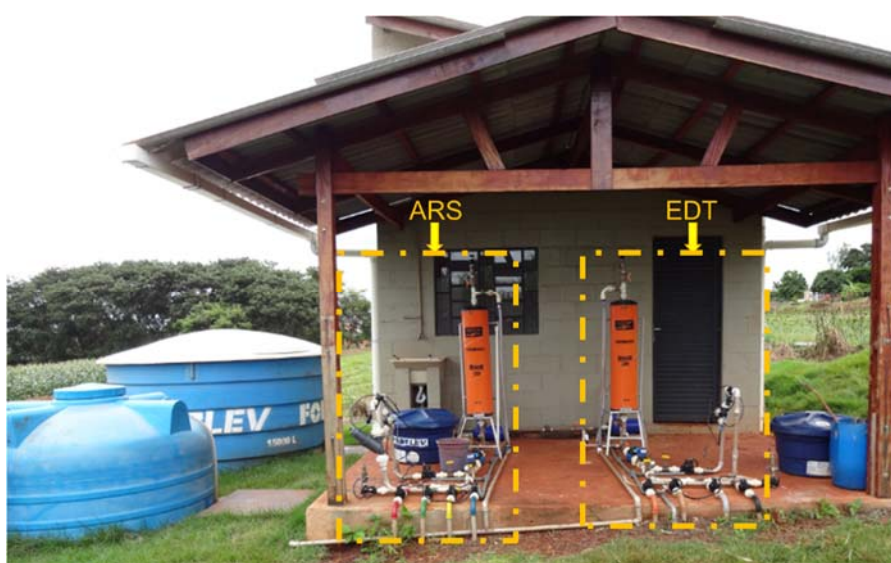
Figura 1. Cabeça de controle para dois conjuntos de sistemas irrigação pressurizados - ARS: Água de reservatório superficial e EDT: Esgoto doméstico tratado.
