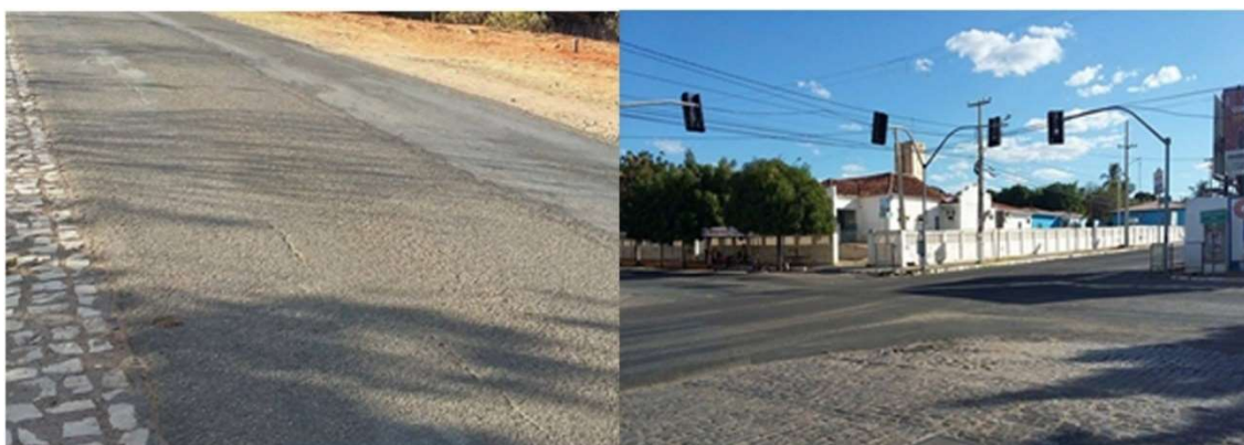
Figura 1. Ausência da sinalização vertical e horizontal
