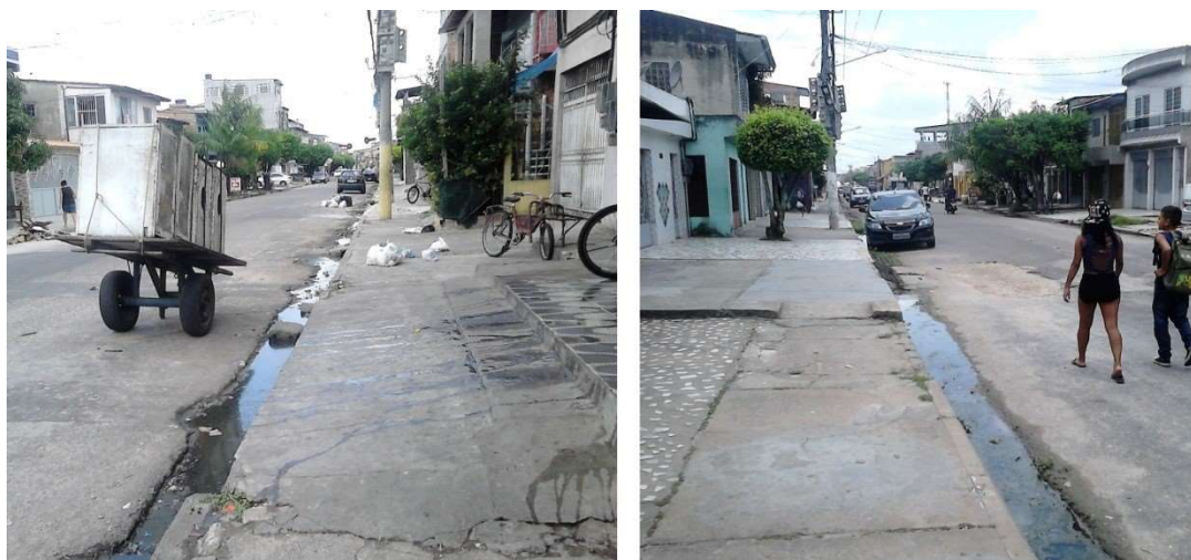
Figura 13. Vista de declividade transversal maior que 8.33%
