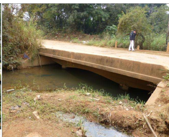
Figura 4 – Detalhe da distância entre o tabuleiro da ponte e a lâmina d'água do ribeirão, no ponto de máxima distância.
