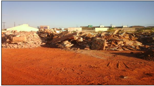
Figura 1 - Deposição irregular de resíduos de construção e demolição na cidade de Sinop/MT
