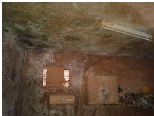
Figura 5.4 - Paredes com presença de umidade da Marcenaria
