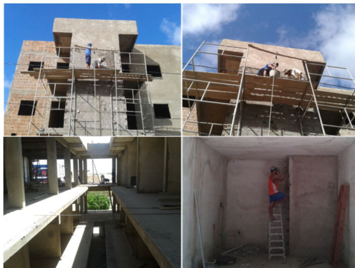
Figura 3 - Imagens de riscos encontrados nos canteiros de obras
