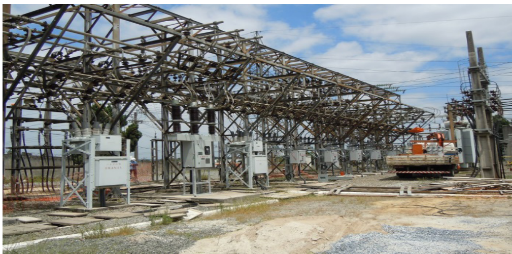
Figura 1. Ambiente de uma subestação
