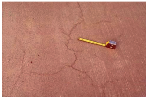
Figura 6 – Fissuração por contração e retração térmica. (Granato, 2014).
