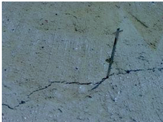
Figura 3 – Fissura causada por retração plástica. (Abcp, 2003).
