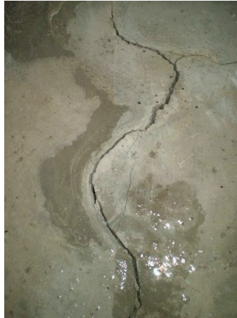
Figura 2 – Fissura no concreto por retração. (Granato, 2014).
