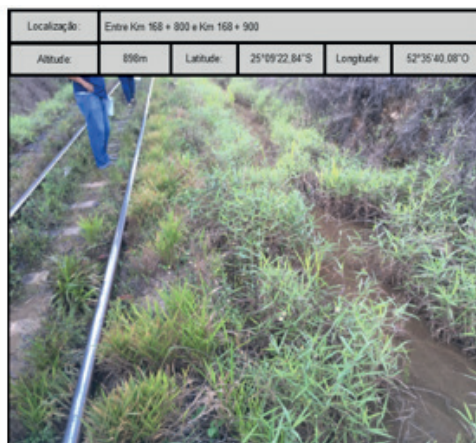
Figura 15 - Presença de vegetação e solo arenoso no talude ferroviário
