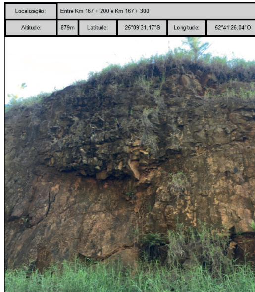
Figura 7 – Encosta com risco de Queda de Blocos
