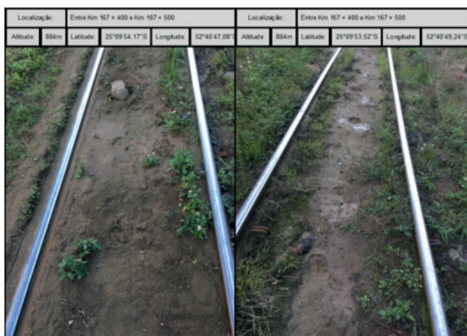
Figura 16 - Acúmulo de solo na linha Férrea
