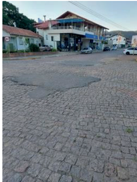
Não conformidades no pavimento
