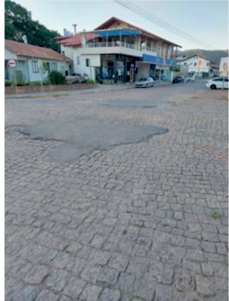
Não conformidades no pavimento
