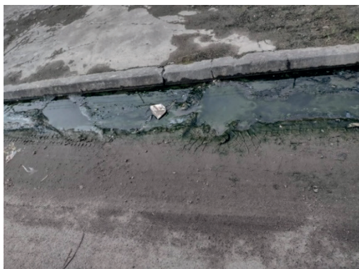
Figura 12 – Ruas com esgoto a céu aberto
