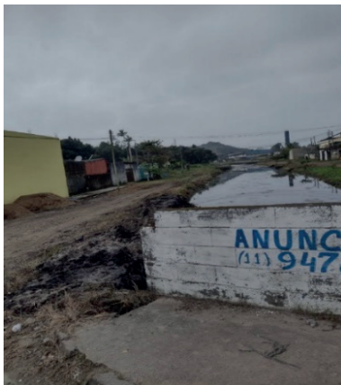
Figura 11– Ruas sem drenagens de águas pluviais
