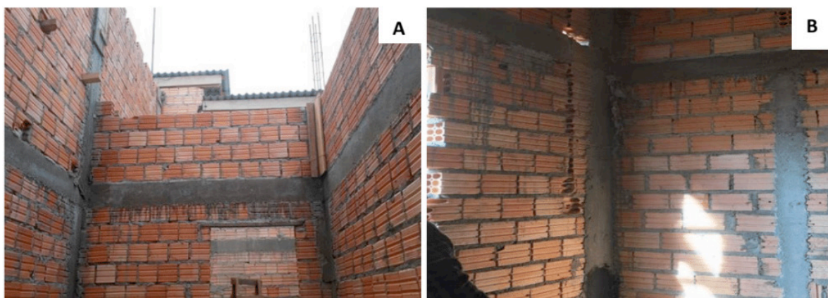
Figura 07: A -Amarração entre a coluna e a viga; B - Fragmentos de material desnecessário e prejudicial ao concreto.
