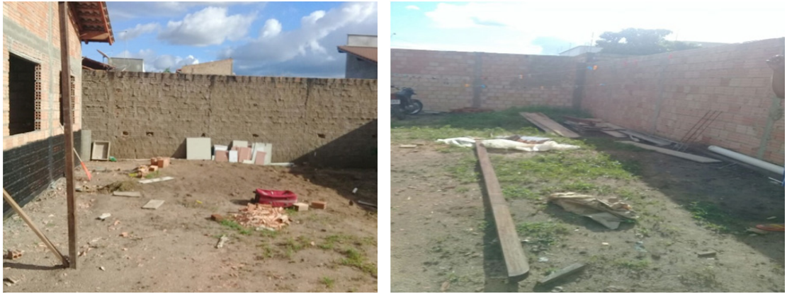
Figura 11:A - Materiais expostos; B – matérias exposto e Muro de alvenaria ao redor.
