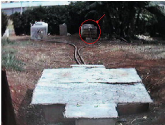
Figura 5 – Caixa de areia onde é captado o esgoto para tratamento. Ao fundo em destaque o tanque séptico modificado.
