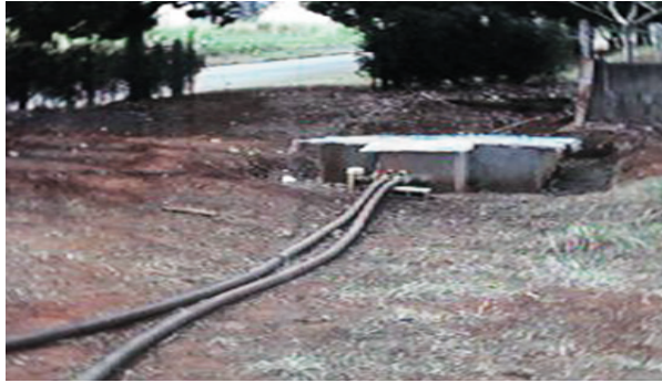
Figura 4 – Vista da caixa de areia com as mangueiras coletoras.
