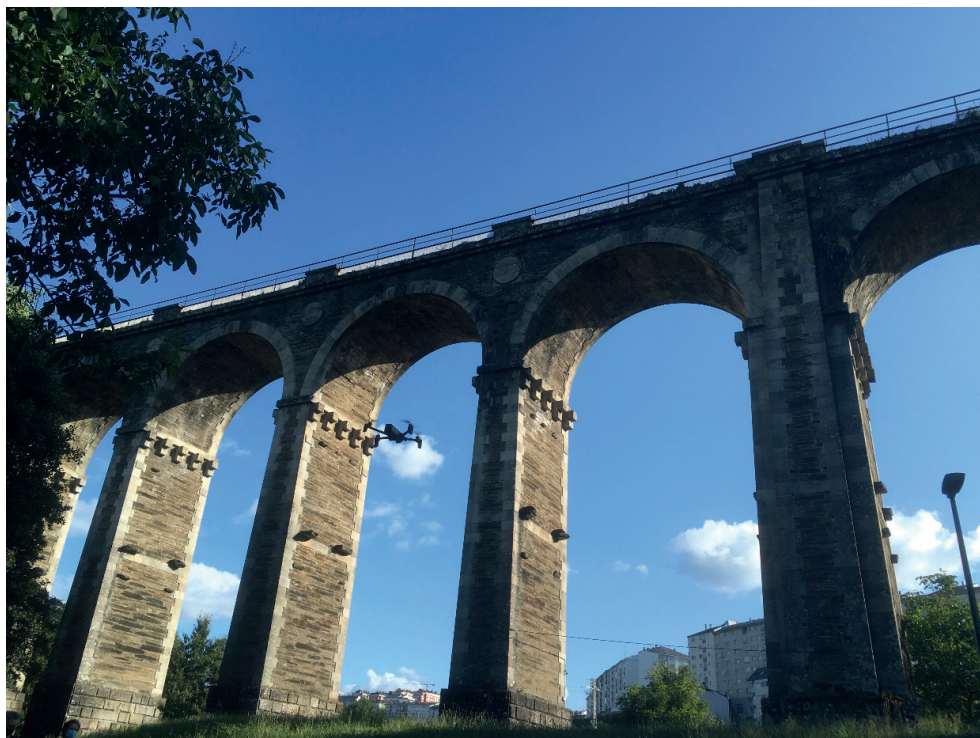
Figura 2: Drone cuadricóptero aproximándose para una inspección sobre el Ponte da Chanca, viaducto ferroviario ubicado en la ciudad de Lugo que el 20 de diciembre de 2021 cumplió 150 años (fotografía del autor).
