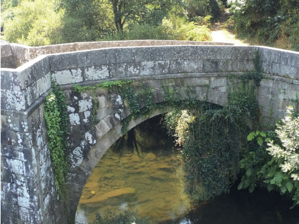
Figura 10: Vista general de unos de los arcos mayores del Puente de Brandomil, visto desde el lado aguas arriba, en imagen captada con el drone multi rotor empleado en la inspección, donde se puede observar la abundante presencia de vegetación enraizada en los múltiples elementos (fotografía del autor).
