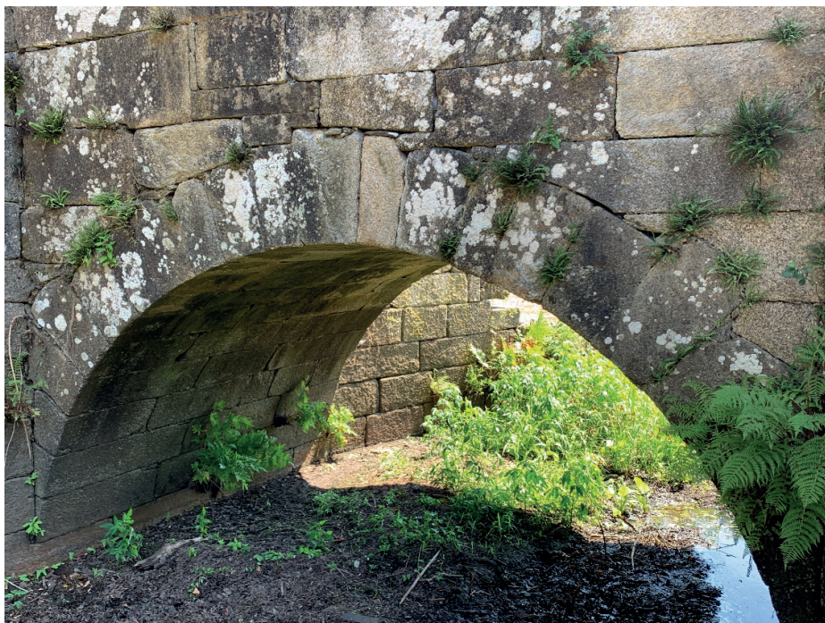
Figura 9: Vista general del arco más pequeño del Puente de Brandomil, visto desde el lado aguas arriba, en imagen captada con el drone multi rotor empleado en la inspección, donde se puede observar la abundante presencia de vegetación enraizada en los múltiples elementos (fotografía del autor).
