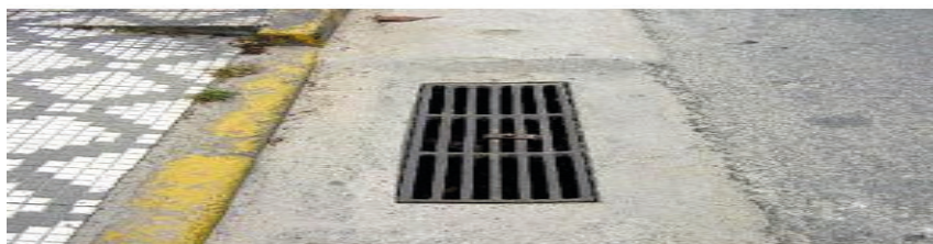
Figura 4 - Boca de lobo com grelha
