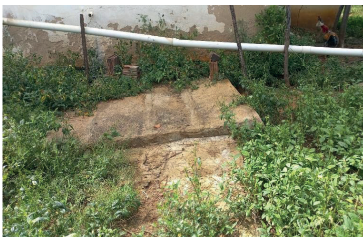
Figura 05: fossa rudimentar (Lagoa Escondida).
