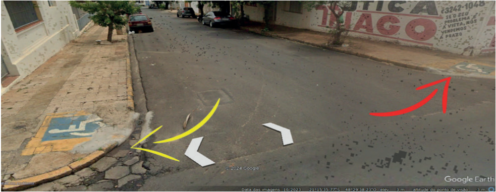
Figura 6. Imagem do trecho, notamos que nela há vários defeitos, desde a falta de um revestimento adequado até o tipo de material utilizado
