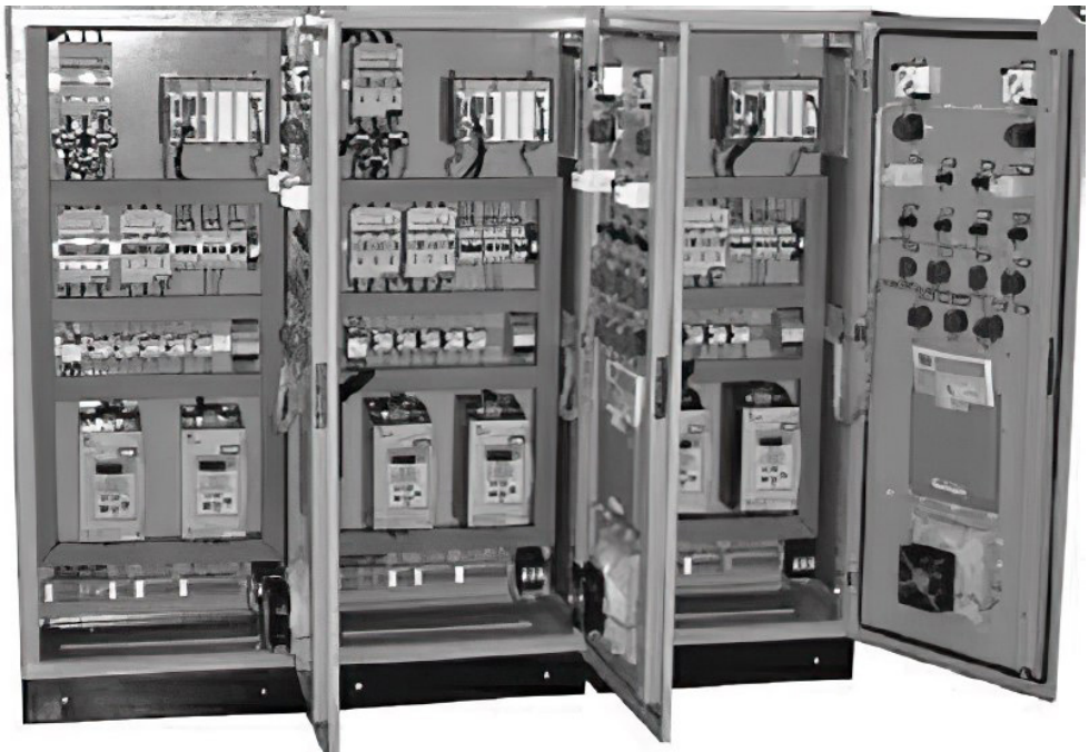
Figura 1 – Vista interna de un panel de baja tensión.
