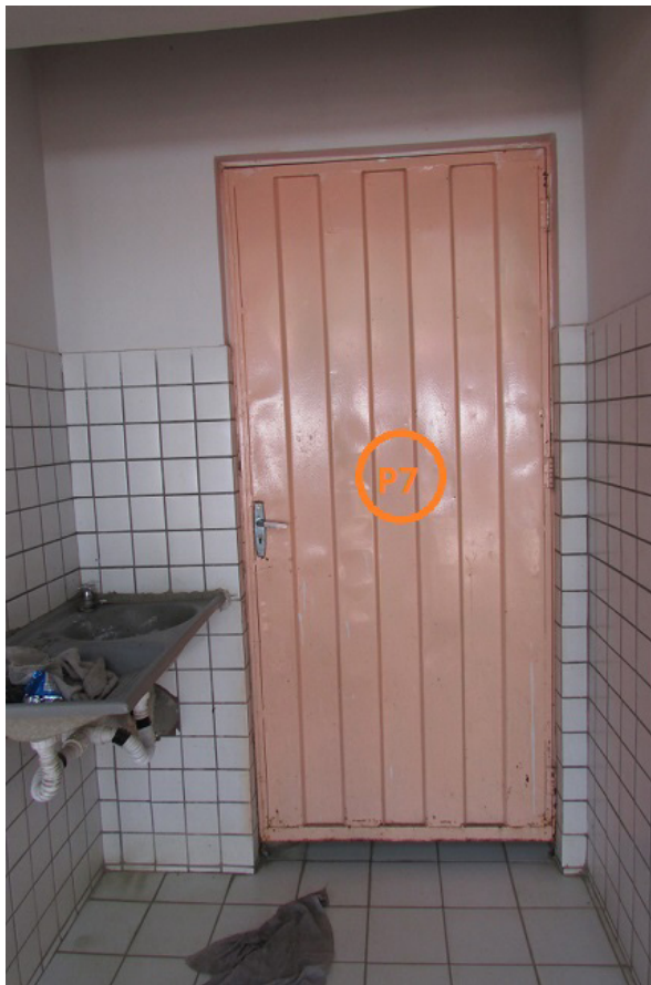
Figura 11– Porta P7 do banheiro para deficientes.
