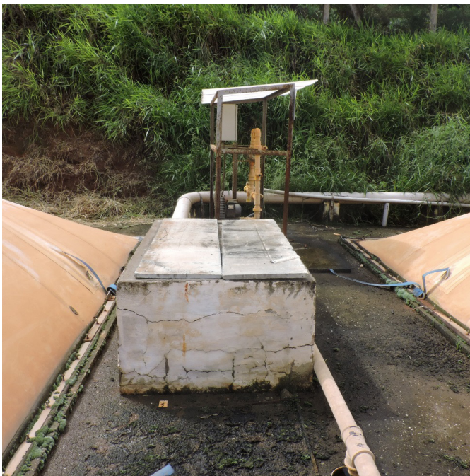
Figura 7. Caixa de distribuição (Fonte própria).
